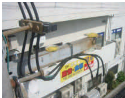
Sur des structures électriques
